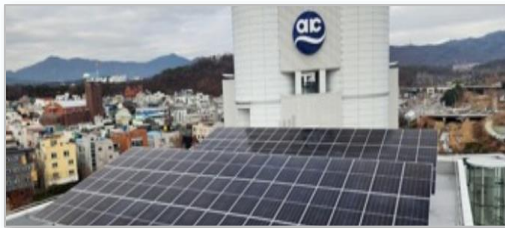
[애경종합기술원 태양광 발전 설비]
